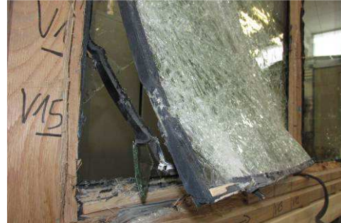
Bild 8 Schäden aus der manuellen Prüfung der Glasanbindung (VSG außen, Ramsauer 670)
